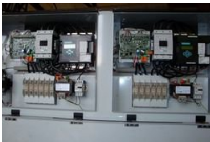
Электронная начинка автоматики теплового насоса
