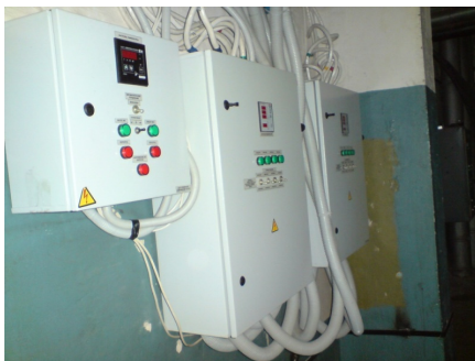
Фото 4. Так выглядит система автоматики «Теплона»
