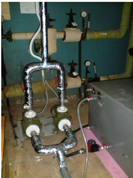
Фото 5. Так выглядят сетевые насосы Теплона (основной и резервный)
