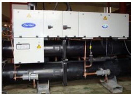
Тепловой насос «Carrier», установленный в ТП «1 Мая»
