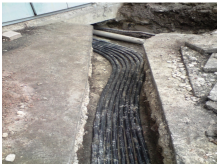
Фото 3. Так выглядит подводка электроэнергии на 2 «Теплона» (в перспективе)
